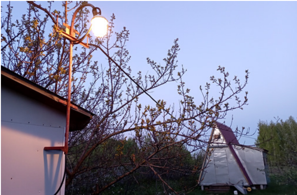
Рис. 3. Общий вид светильника с управлением из двух точек
